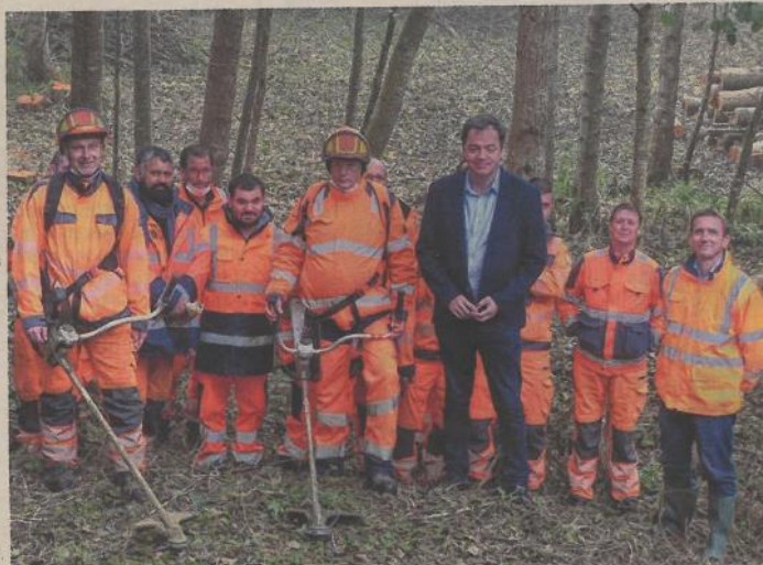
Nicolas Gravelle et Antoine Tréboz (à droite) au milieu des personnels du chantier.
